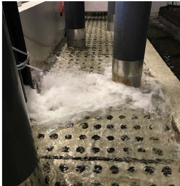
Figur 3: Tilkost til CO 2 luftere kan være utfordrende. Her vist ved en vakumlufter, hvor området under stålplaten er vanskelig å komme til.
