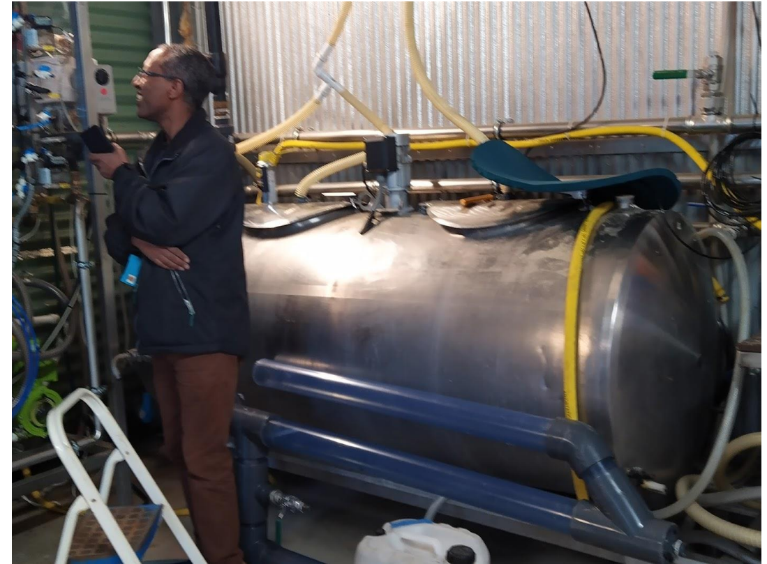
Biogassreaktor for produksjon av energi og gjødsel
