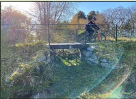
Saueundergang og potensiell oversvømmelsesrute fra innsjø.
